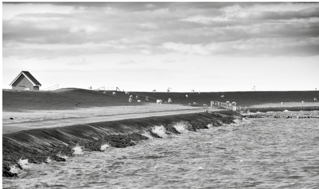
Am Hafen von Wyk beginnt der 25 km lange Deich, im Bild das Lagelum Siel.
